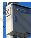
電源ボックス
