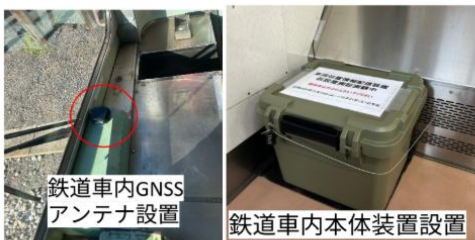
図 6-71 鉄道内 GNSS 設置
