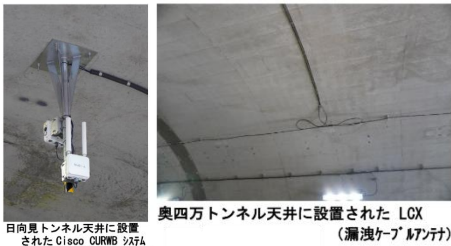
図 6-6 トンネル内設置に設置した CURWB システムと LCX
