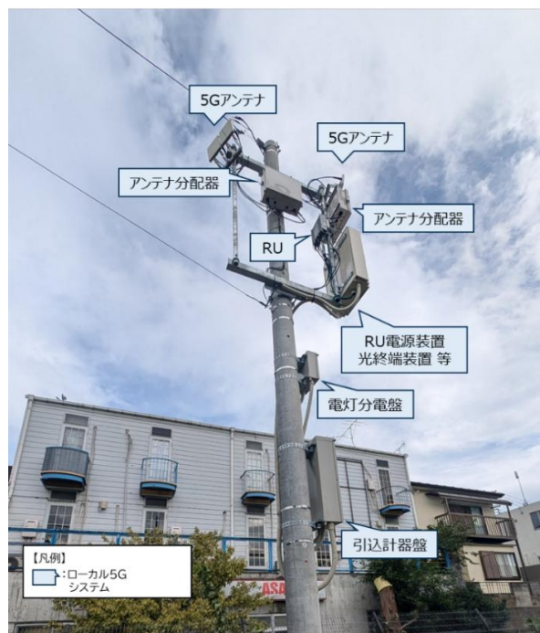
図 5-8 基地局①の設置写真
