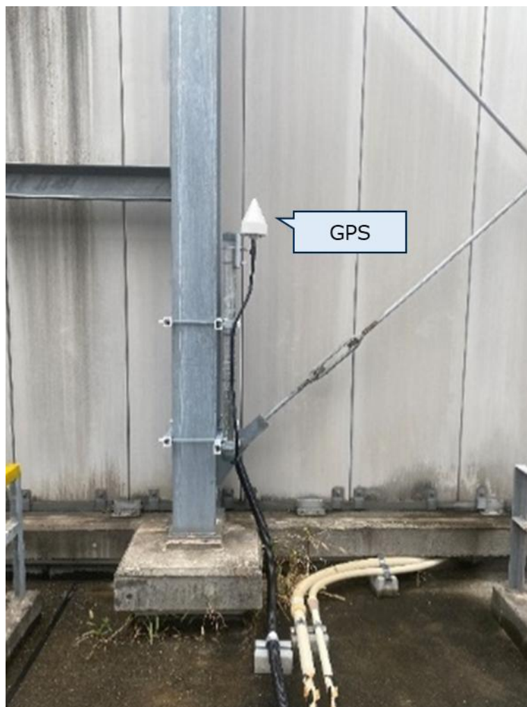
図 5-6 GPS の設置写真
