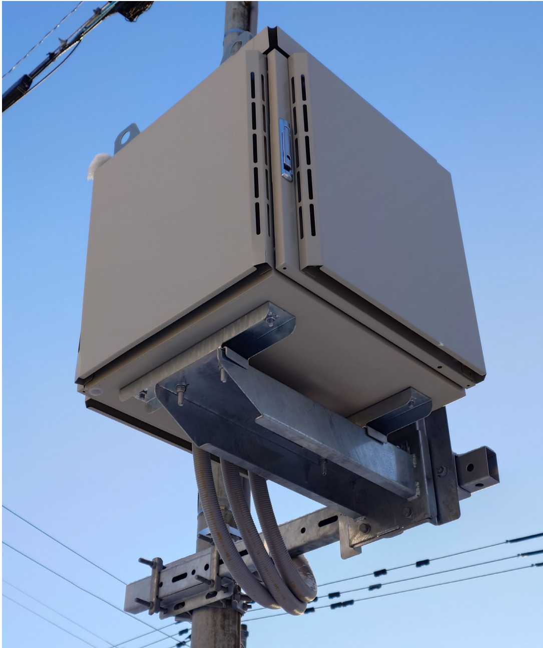
図 18 APN 終端局の設置写真
