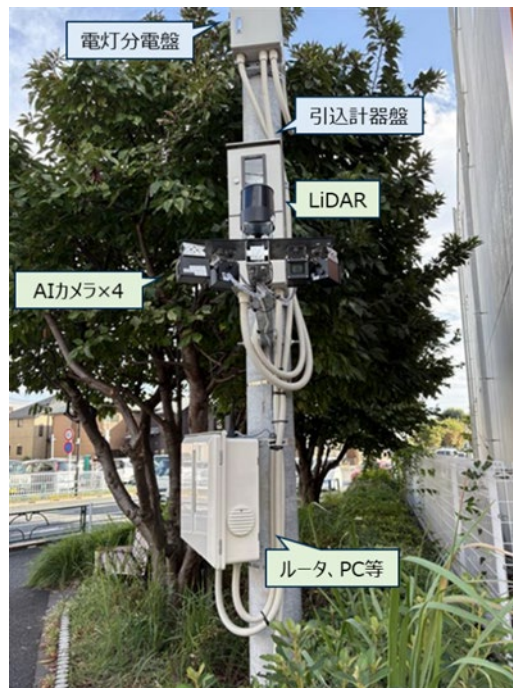
図 4-6 新たに構築したローカル 5G スマートポール(装柱型) [田中橋交差点]
