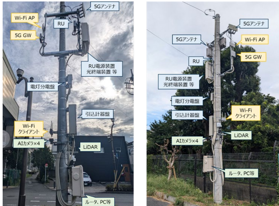
図 4-5 2024 年度実証で構築した既設ローカル 5G スマートポール(装柱型) [左:和泉多摩川駅、右:多摩川住宅]
