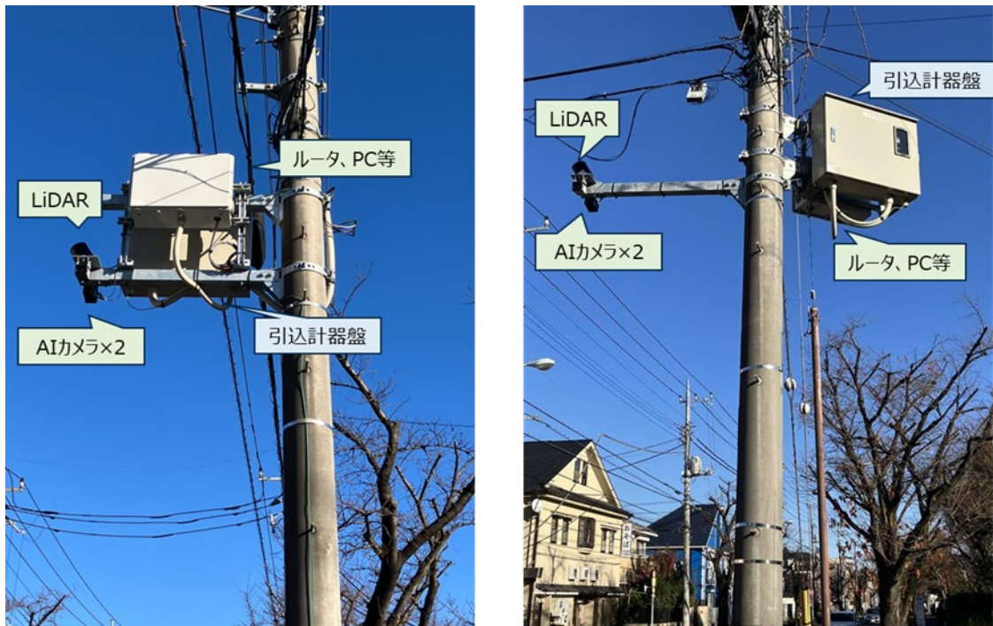
図 4-30 新たに構築したローカル 5G スマートポール(添架型) [六郷さくら通り]
