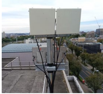
図 4-28 新たに設置したローカル 5G 基地局
