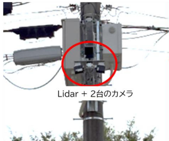
電柱に取り付けたセンサー
